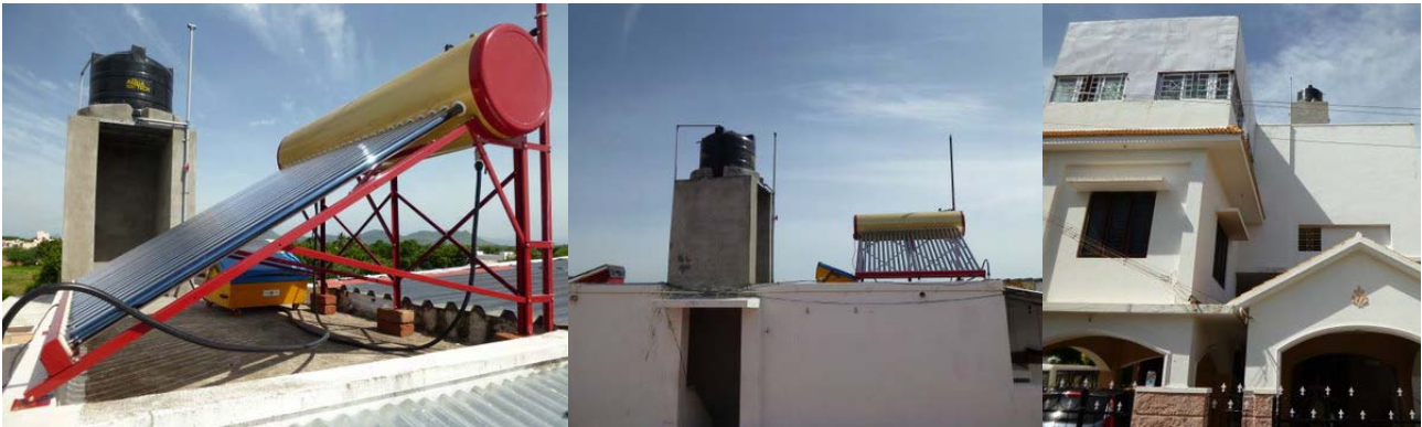
Zonneboiler op het dak
